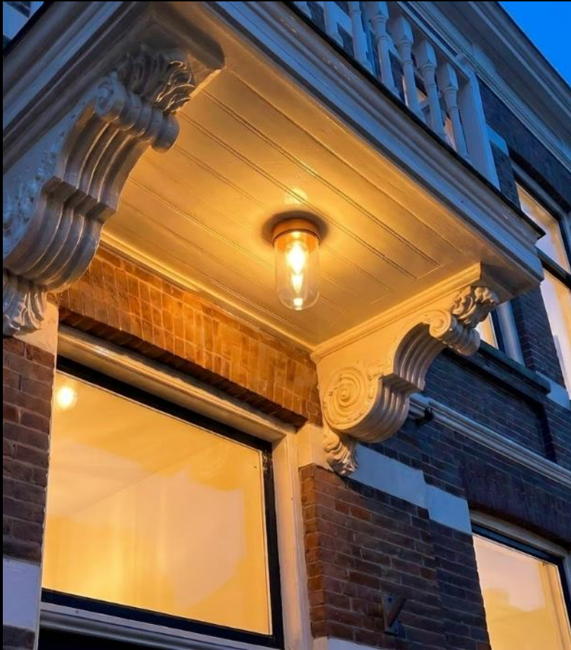
Kleine nieuwe armaturen (aangesloten op bestaande electrische infrastructuur)
